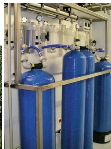
Traitement de l'eau
